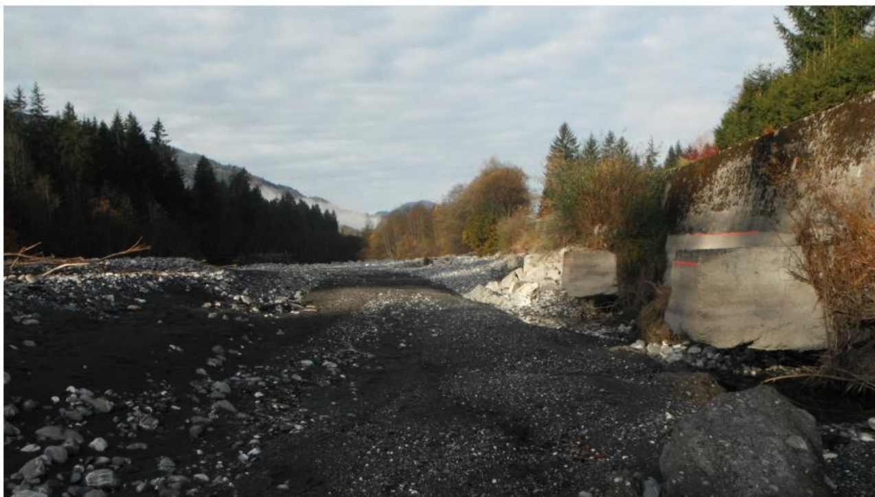
Figure 3 : Vue de la digue et des épis déchaussés, un chenal d'une largeur de 9 mètres et d'une profondeur de 1,7 m s'est développé le long de la digue
