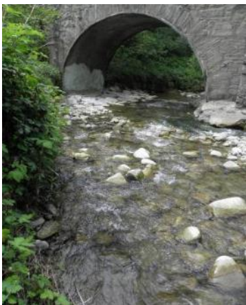
En amont, rive gauche, la faune ne peut accéder à l'ouvrage
